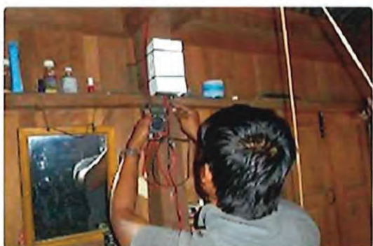
屋内配線も当然、テスターでチェックを行いながら結線していきます。
